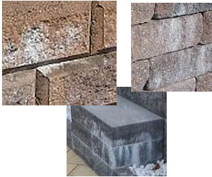
Bilder 1: Eingefärbte Betonmauersteine mit Kalkausblühungen - oft zu sehen in Händler-Ausstellungen! Auch in Baugebieten fallen einem so hässliche Fleckbildungen oft auf. Sie werden verursacht durch anhaltende Nässeinwirkung - bei kühler Witterung - in den offenporigen und dadurch sehr saugfähigen (frischen) Betonwerkstein.
