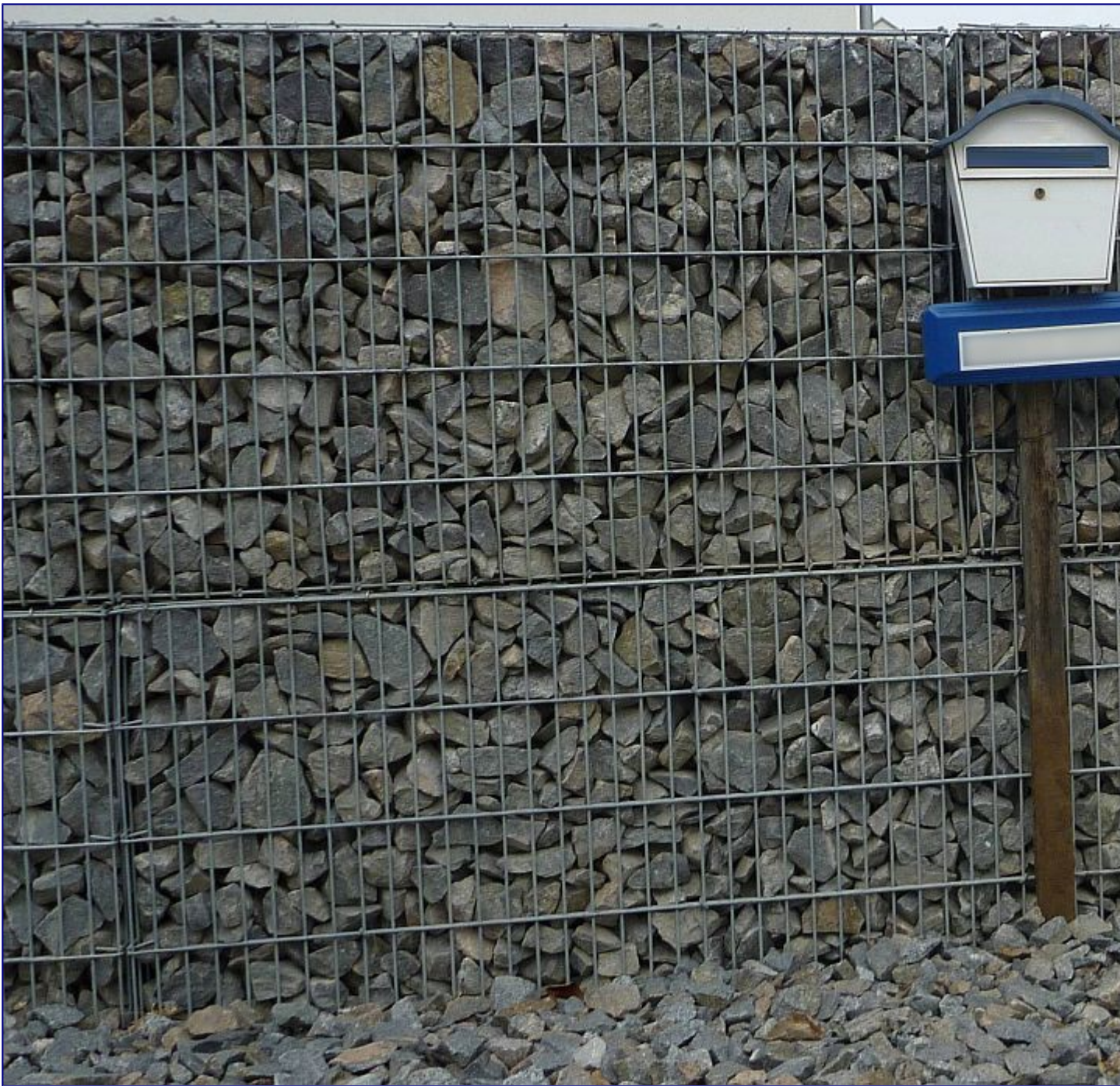
Bild 01: Drahtgabionen-Schottermauer mit „Bunkerwirkung“ + Briefkasten- „Notlösung!“. Einfahrt ungesichert!
