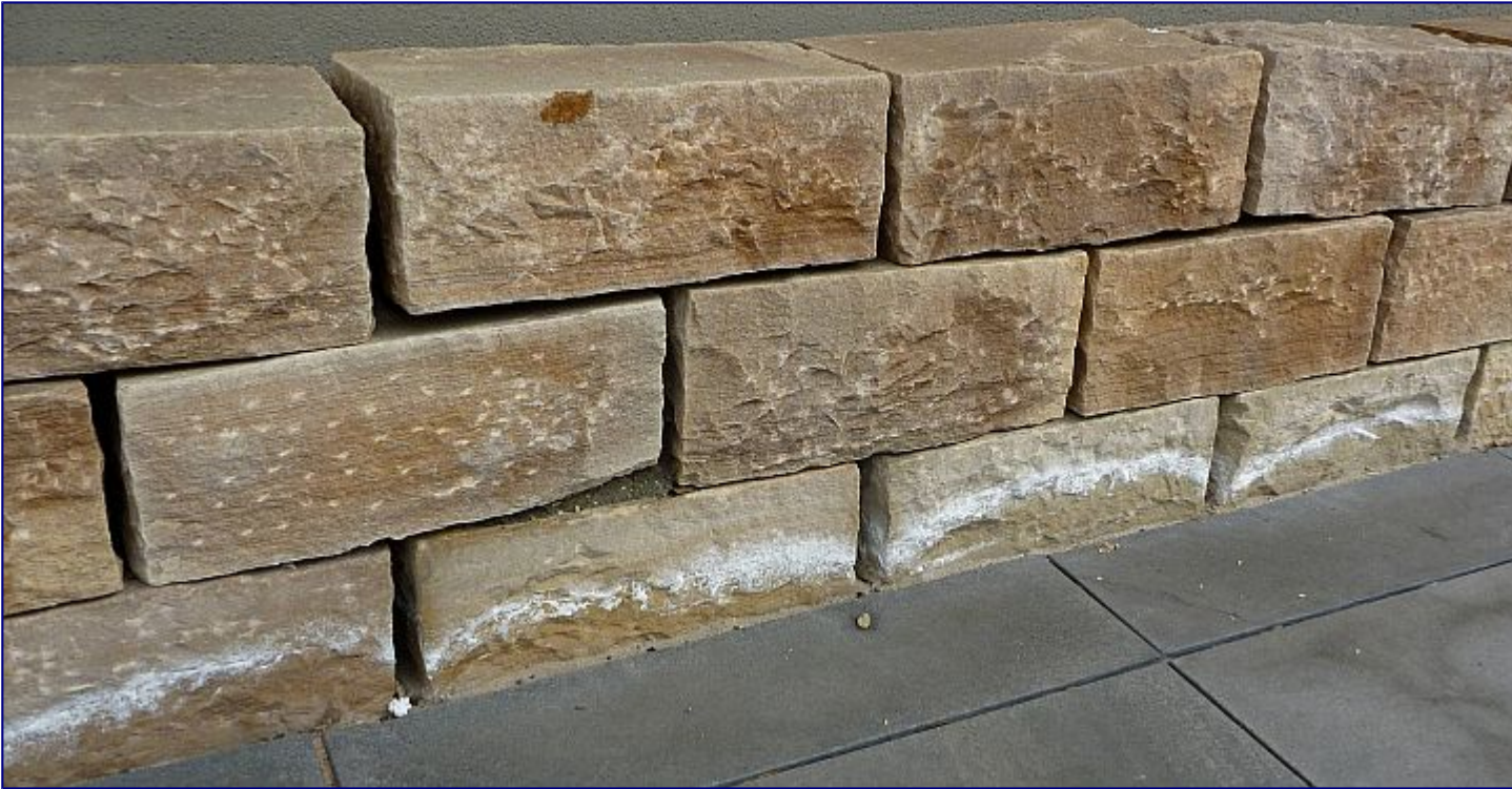
Bilder 02: Hässliche Betonmauern mit Kalkausblühungen = mit oft langjähriger Beeinträchtigung der Garten-Gesamtansicht.
